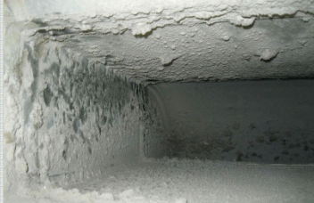
Lüftungsschacht vor der Reinigung
